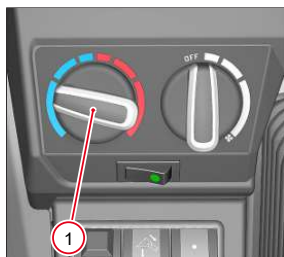
Bild. 125: Inställning av värmartemperaturen
